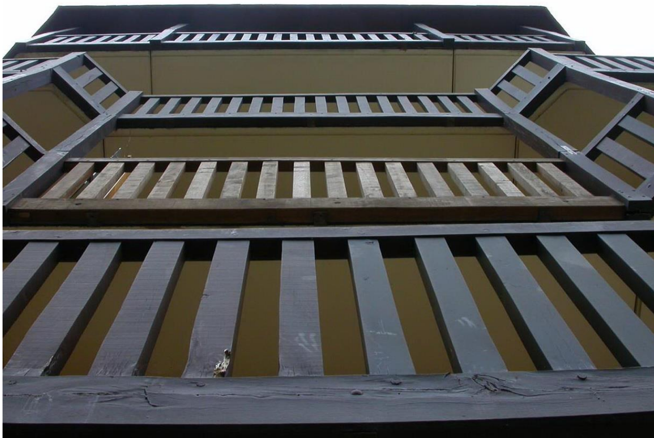
Fig. 1 : Vue d'une partie des garde-corps attaqués par la pourriture fibreuse blanche
