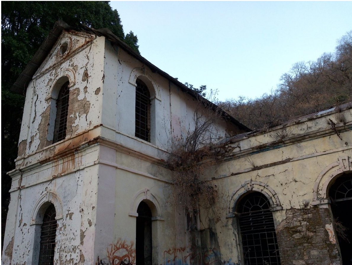
Figura 2-12. Vista actual del estado de conservación del CM1, las grietas son evidentes lo cual, permite suponer un daño estructural.
