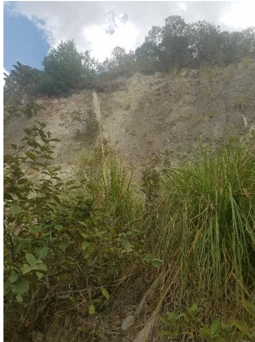
Ilustración 12. Vista del cerro donde se producen los deslizamientos.
