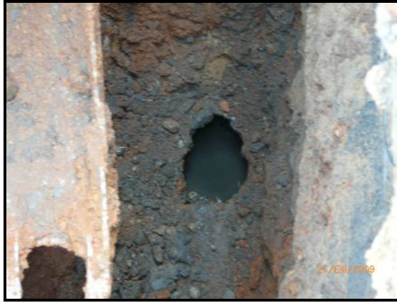
Alt yapıda çöken yağmur suyu hattının durumu
