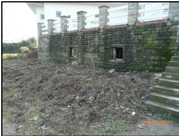
Lokal Dış Cephe Bakım Öncesi
