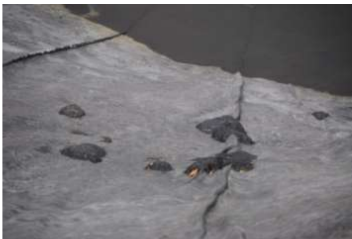
Fot. 21. Zniszczone zniesienia żaby trawnej, odsłonięte w wyniku szybkiego spadku poziomu wody w zbiorniku
