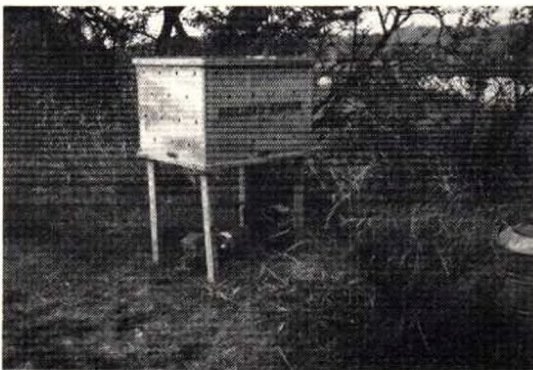
Generatoren har fået "husly" for at holde eventuel regn væk
