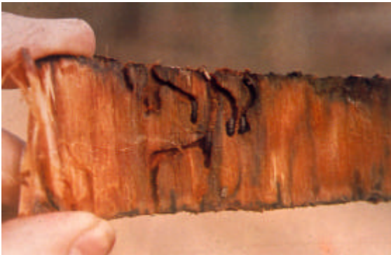
Daño leve a la madera.
