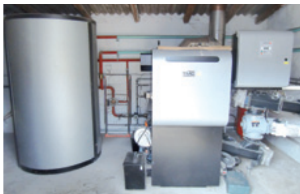
Esempio di centrale termica a cippato.
