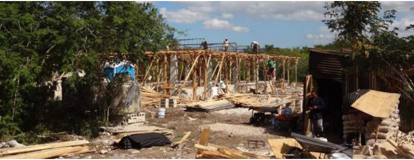
Inicio de la construcción de los edificios del JBO, 22 de noviembre de 2012.
