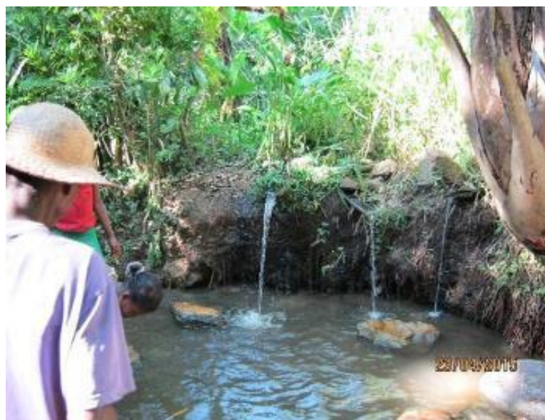
Photo 25 : Captage de source par une technique traditionnelle
