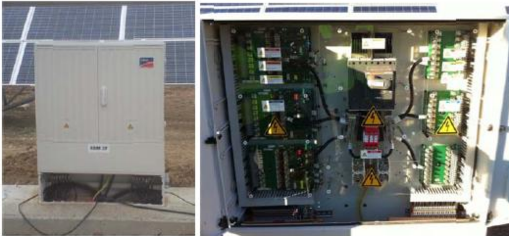
Cuadro de protección de string
