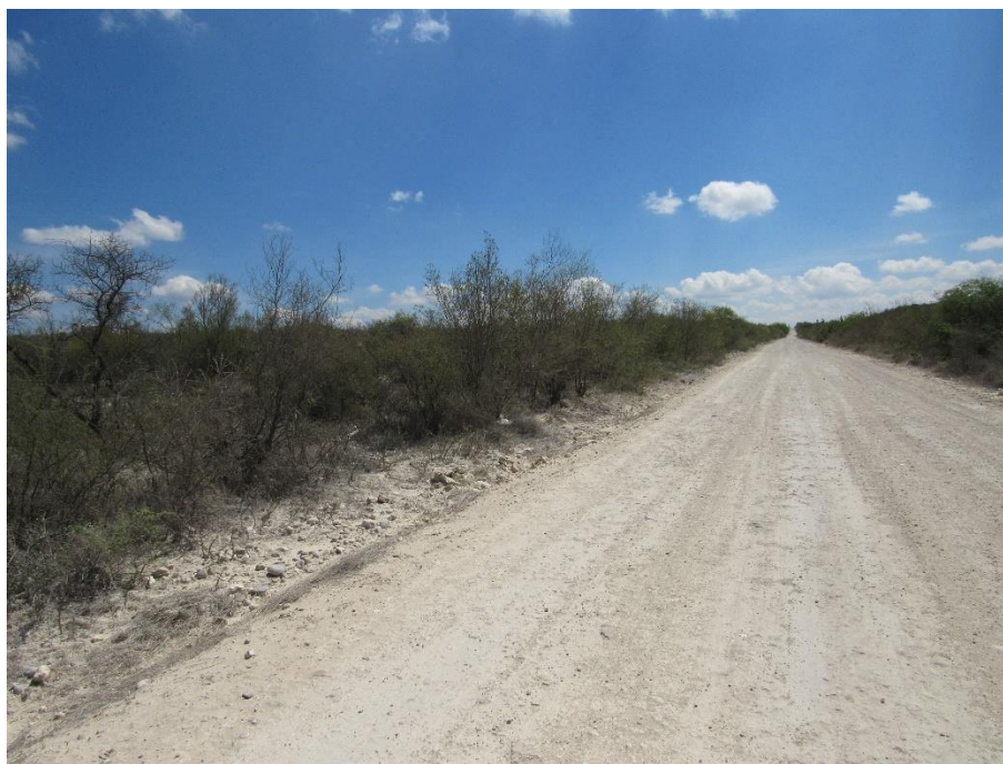
Figura 95. Aspecto general del camino, aproximadamente en el Km 11+700, hacia adelante, ligera afectación en las colindancias, zona de los polígonos de afectación 20B y 26B
