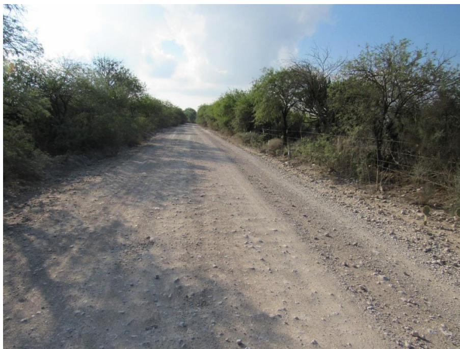
Figura 91. Aspecto general del camino, aproximadamente en el Km 9+600, ligera afectación en las colindancias, zona de los polígonos de afectación 10B y 11B
