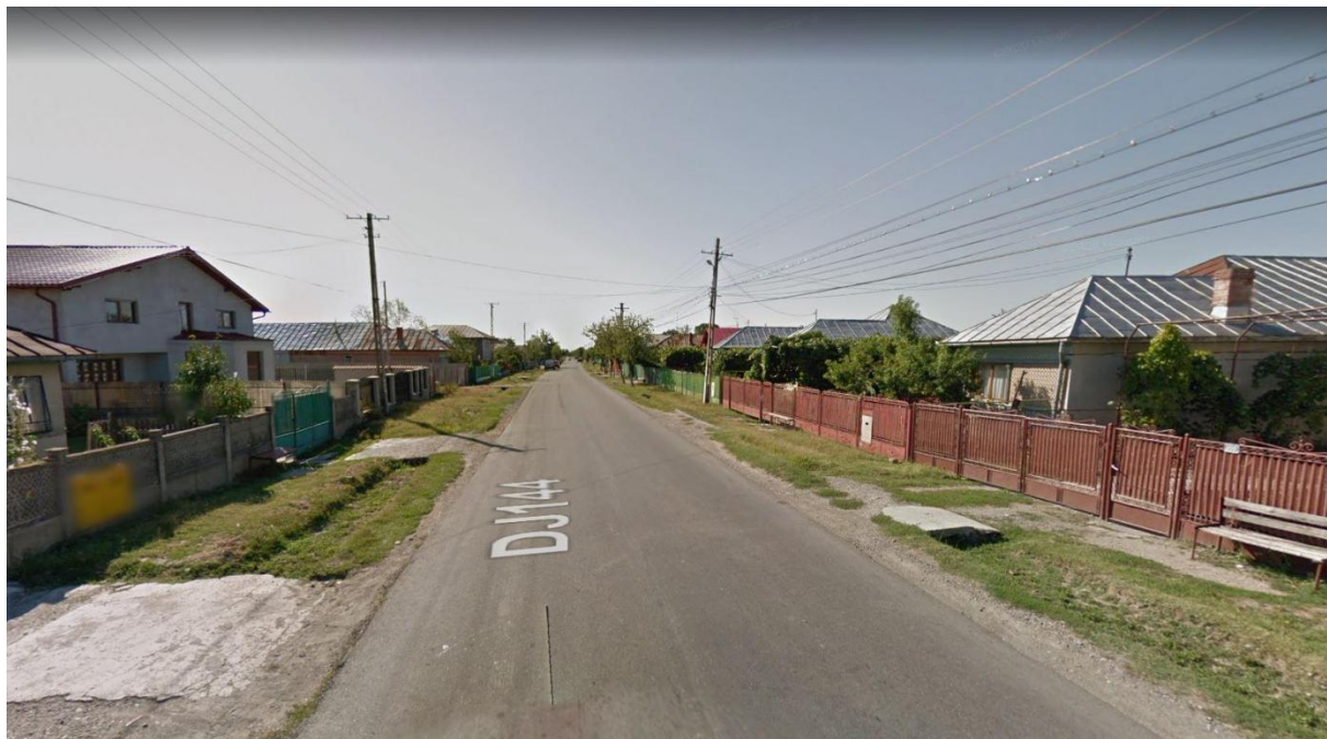
Foto: DJ 144, sat Nedelea (sursa: Google street view) – zona pietonală în stare avansată de degradare
