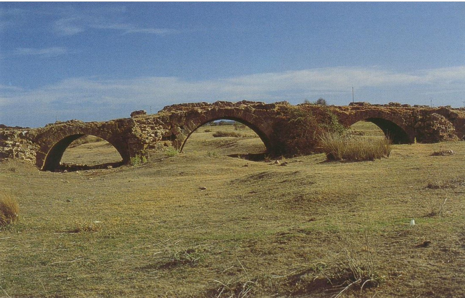
Foto 3. Bella reliquia de puente romano sobre el río La Valmuza, en la calzada de Miróbriga a Salamanca, enlace con la vía de La Plata (Mérida a Astorga) y las vías pecuarias en dirección a Medina del Campo, mercado central español más importante de ovino durante la trashumancia. Calzadilla. 1992. (Foto J. Berrocal).
