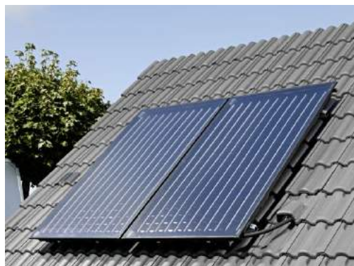
Rys. 4. Płaskie kolektory słoneczne na dachu budynku [www.instalacjebudowlane.pl]
