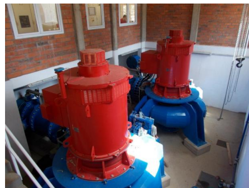
Figure 17. Exemple de deux groupes Francis à axe vertical
