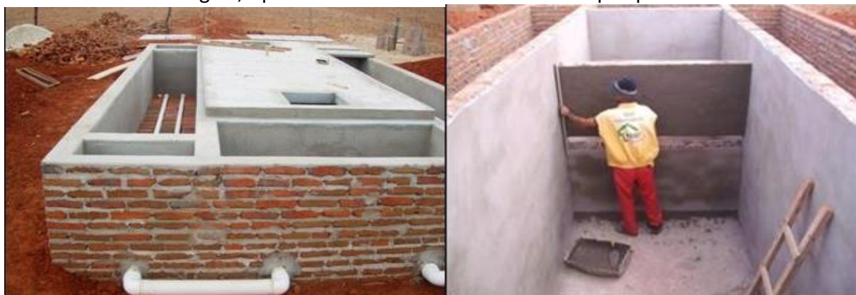
Figura 2. Sistema modular de tratamento de esgoto doméstico construído no Assentamento Milagres, Apodi-RN. Fonte: Dados do acervo de pesquisa.
