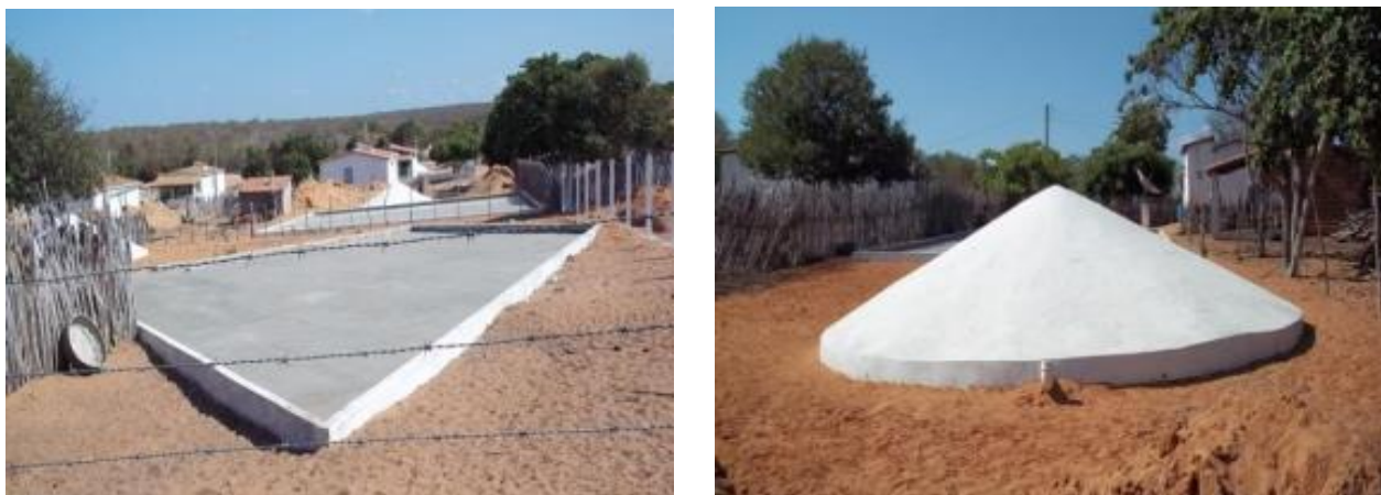
Figura 2. Área da cisterna calçadão (capacidade de 52 mil litros).
