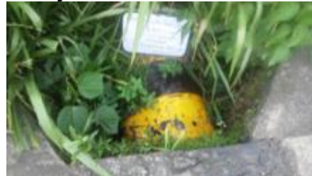
Estructura obstruida por una caneca. PK88+116
