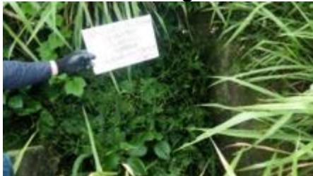
Obstruida completamente por vegetación a la entrada y no se observa salida PK98+103
