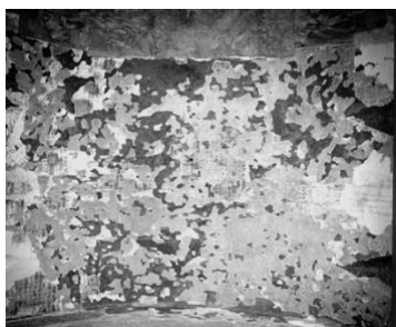
Figura 4. Estado conservación de zona de la bóveda. (José Luis Regidor, 2006)
