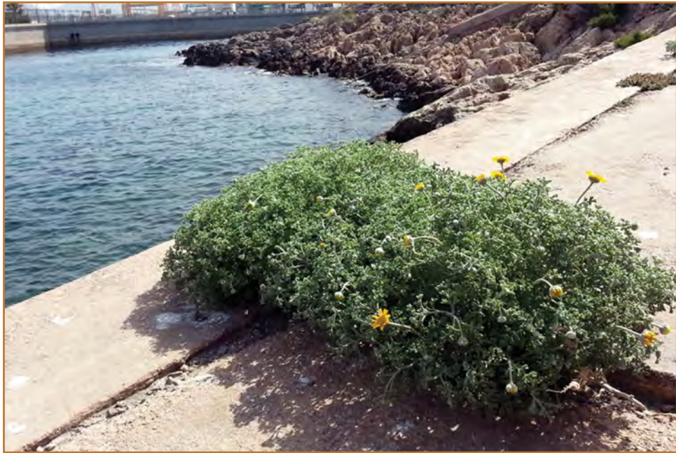
Figura 5. Ejemplares de Anthemis chrysantha de gran tamaño creciendo entre las fisuras de hormigón en la Isla de Escombreras.
