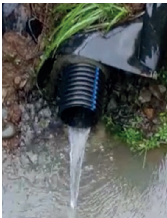
Foto 9.3. Dren subsuperficial en operación, en zona de vega.
