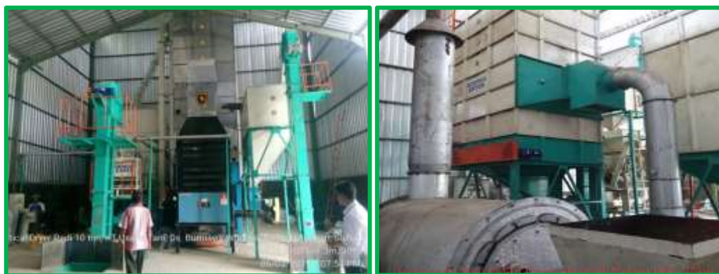
Gambar 19. Vertical Dryer Kapasitas 10 Ton di Kab. Polman, Sulbar dan Rokan Hilir, Riau
