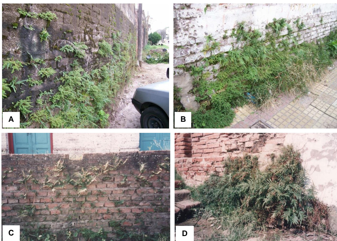
Figura 2.2. A. Pileo-Pteridetum vittatae creciendo en las grietas de una pared orientada al S; B. Pileo-Pteridetum incipiente en la base de una pared de ladrillos y mezcla con pintura deteriorada. En ambas fotos predomina Pilea microphylla . Corrientes Capital. C y D. Zócalo y base de pared muy meteorizados con predominancia de Pteris vittata . Barranqueras, provincia del Chaco.
