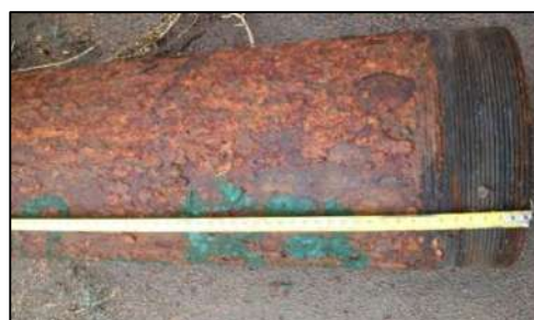
Fotografía 9.3. Vista en detalle de la corrosión observada en el caño de acero del pozo P4.
