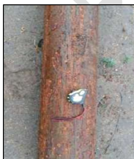
Fotografía 9.2. Corrosión observada en un caño de acero reemplazado en el pozo P4.
