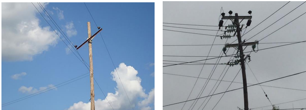
Ilustración 20 Tendido eléctrico en mal estado
