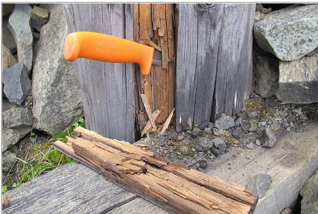
Figur 3. Det ytre sjiktet av treverk er uskadet mens de indre delene er sterkt nedbrutt.
