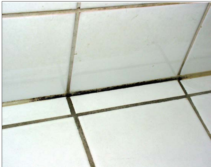
Figur 1. Misfarging av silikonfuge på grunn av vekst av hussvertemugg.
