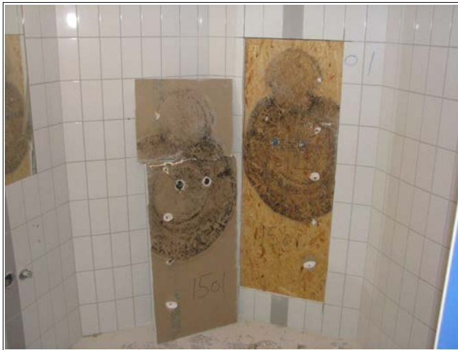
Figur 3. Karakteristisk muggsoppskade i avdekket dusjvegg. Characteristic mould damage in exposed shower wall. Foto: Mycoteam as.
