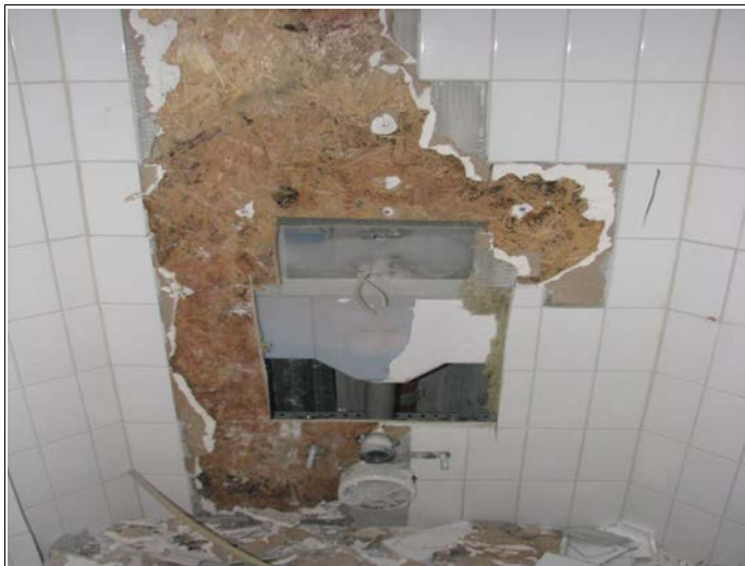
Figur 4. Lekkasje på innebygget toalettsisterne og vekst av svart vannskademugg var vanlig forekommende i de undersøkte badene. Leakage of built-in toilet cistern and growth of Stachybotrys chartarum was commonly encountered in the surveyed bathrooms. Foto: Mycoteam as.
