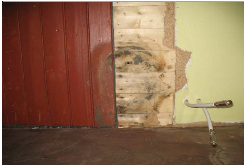
Figur 5. I forbindelse med enn vannlekkasje ble det en lokalt kraftig vekst av raggråtemugg ( Chaetomium globosum ).
