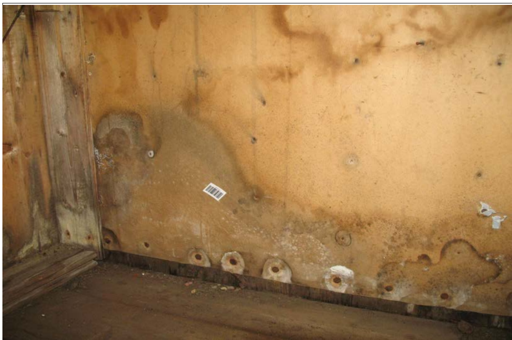
Figur 3. Muggsoppskaden er godt etablert der det er en kombinasjon av stor fuktbelastning og gunstig temperatur, det vil si langs nedre del av veggen.
