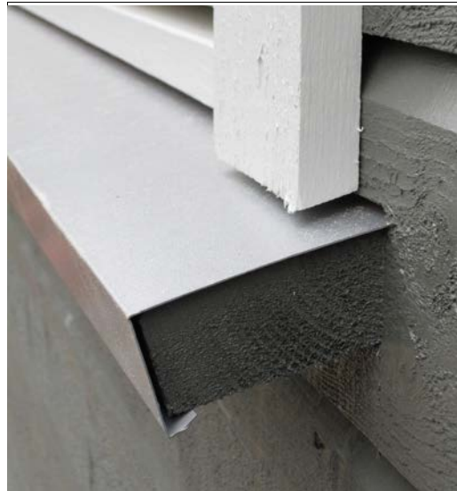
Figur 2. Konstruktiv beskyttelse – beslag på vannbrett under vindu, behandling av endevved, avstand mellom endevved og vannbrett.
