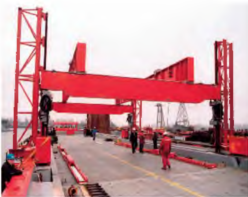
Figuur 6: De hefinstallatie (foto: Damen Shipyards)
