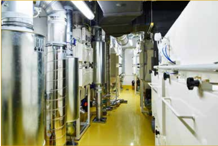
Abbildung 3: Filterraum | © Marcel Billaudet
