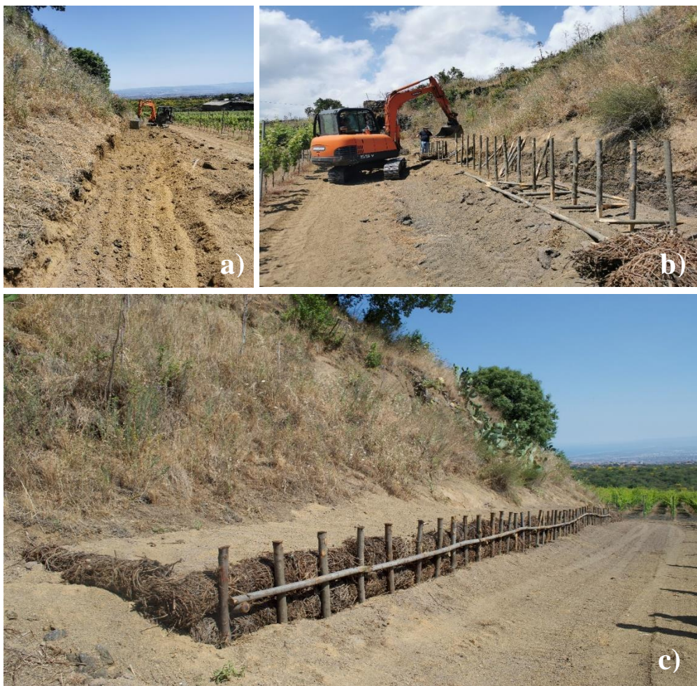
Figura 3.71 Messa in opera prototipo A1; a) scavo, b) realizzazione palizzata, c) opera finita.
