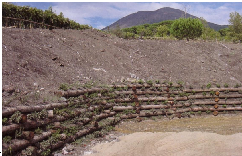
Figura 3.90 Sistemazione con interventi innovativi di Ingegneria Naturalistica nel Parco nazionale del Vesuvio Trecase (NA) – (da ACER 2007).
