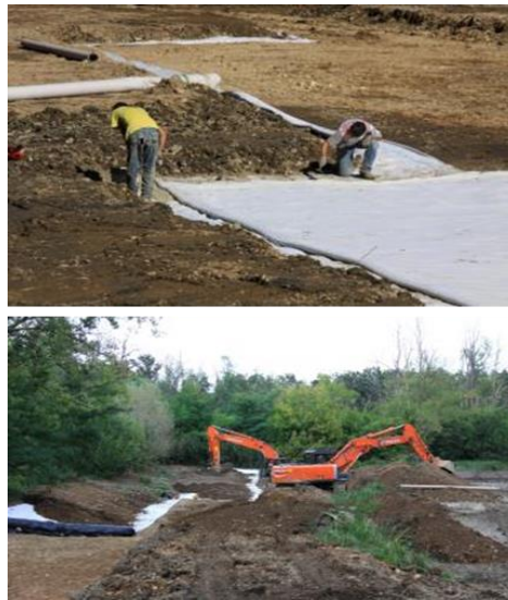
Figura 4.38 Scavi e posa del geocomposito per le impermeabilizzazioni. Bosco WWF di Vanzago (2015).
