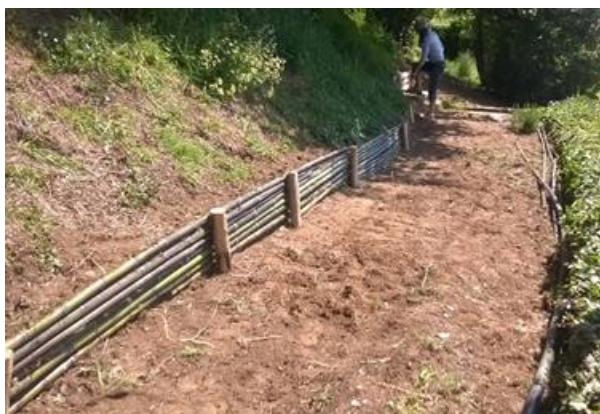
Figura 1.29 Riutilizzo di tronchi di bamboo. Cantiere didattico AIPIN Sicilia e Piemonte (Luserna -S. Giovanni 2016).
