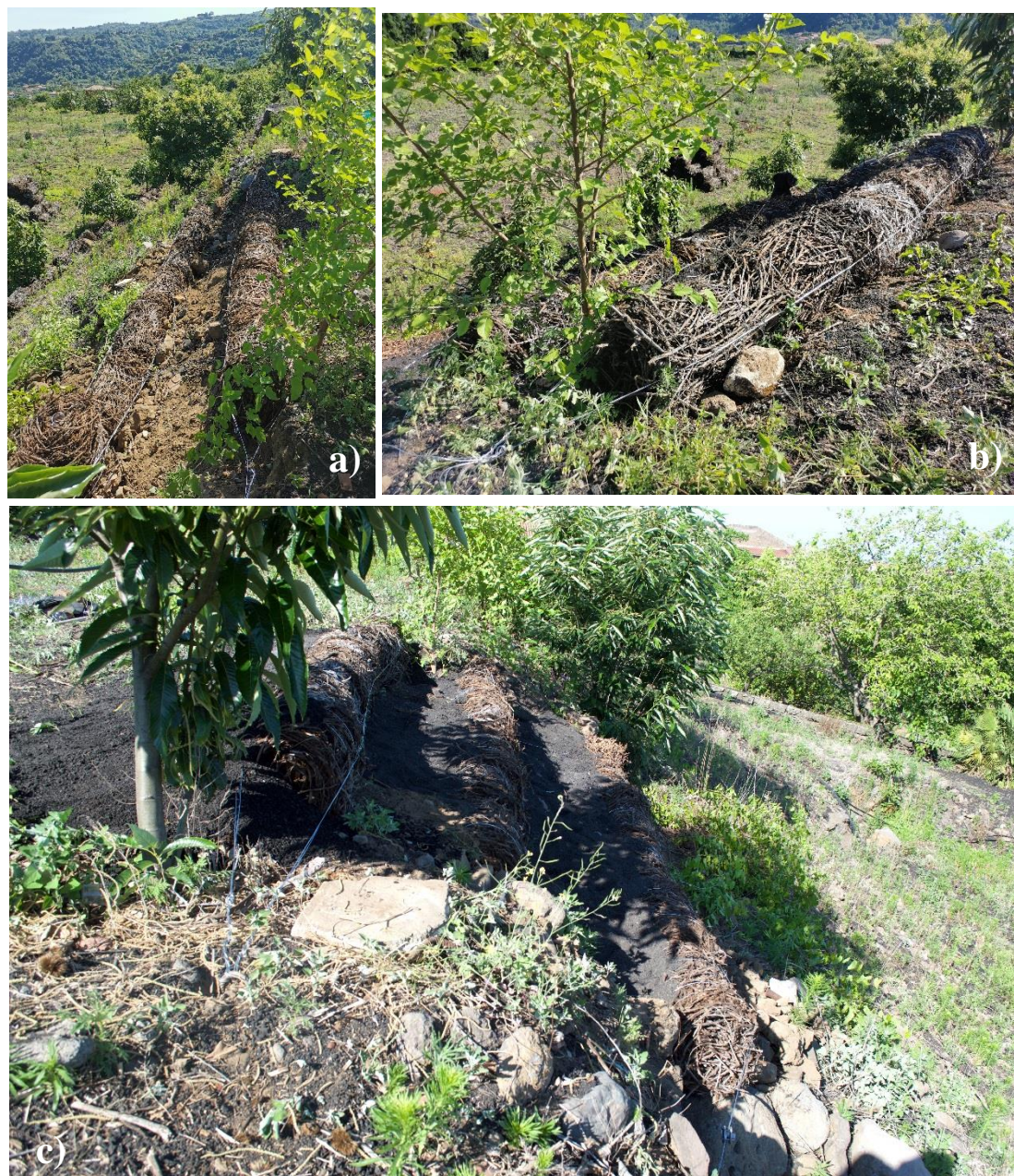
Figura 3.74 Messa in opera prototipo B2; a) posa dei primi due gradini, b) dettaglio dei cavi di collegamento e dell'ancoraggio, c) opera finita
