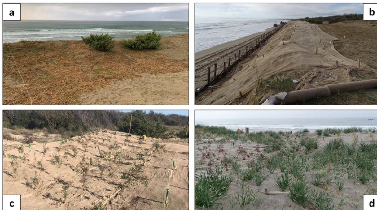
Figura 3.7 Operazione di pacciamatura della superficie della duna (a); posa di bioreti (b); esemplari di Pistacia lentiscus (L.) messi a dimora su duna (c); sviluppo di Pancratium maritimum (L.) ad un anno dal termine dei lavori (d).
