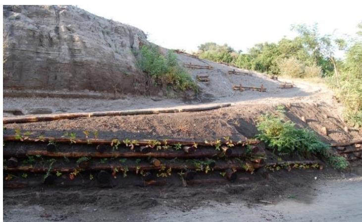
Figura 3.85 Ricomposizione ambientale: mitigazione rischio idrogeologico. Sant'Anastasia (NA) (Gradonata mista con talee e piantine, Palizzata, Palizzata viva tipo Montaguto, Grata viva, Palificata viva doppia) 2015.
