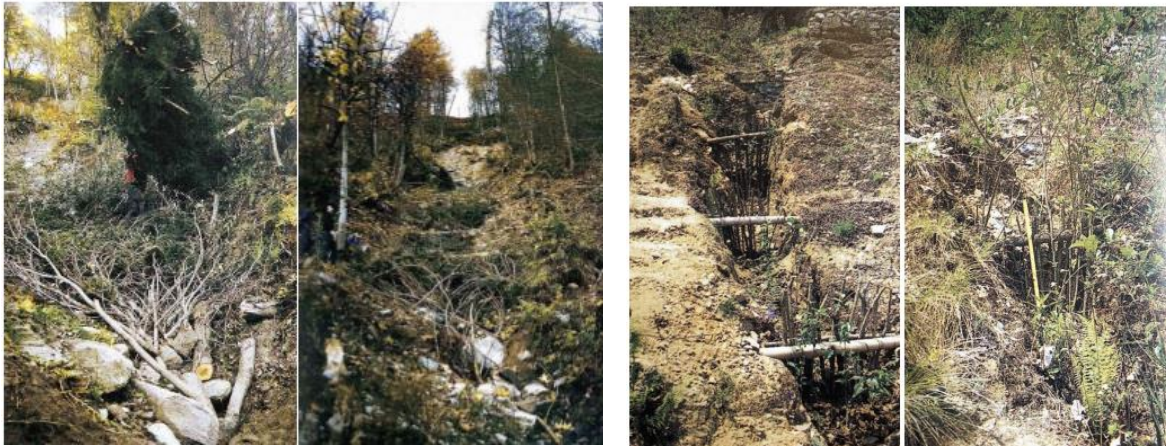
Figura 1.15 A sinistra, cespugliamento solchi con ramaglia viva e morta presso Campo (Canton Ticino, Svizzera). I solchi sono dei fossi di dimensioni ridotte, profondi e larghi fino ad 1 metro. Fonte Florineth F. (2007) A destra, consolidamento di solchi minori mediante la palizzata viva. Intervento sulla frana di Thankot in Nepal dopo due mesi dall'ultimazione. Fonte Florineth F. (2007)
