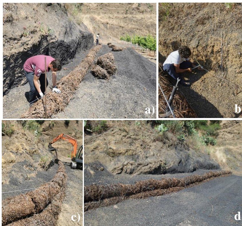
Figura 3.72 Messa in opera Prototipo A2; a) allineamento e collegamento fascinata, b) tensionamento cavi, c) riempimento a tergo, d) opera ultimata.
