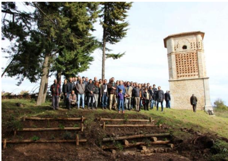
Figura 3.75 Cantiere didattico di Ingegneria Naturalistica – Buonalbergo (BN) 2009 (Gradonata mista con talee e piantine, cordonata e Palificata viva doppia).
