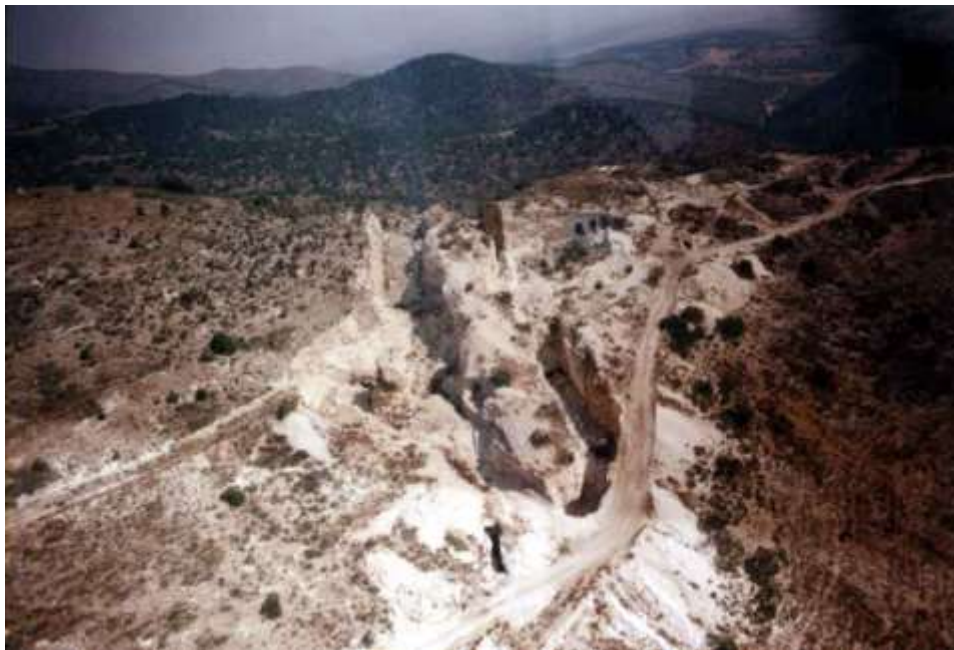
Derrumbes de los túneles sin apuntalar, ¿cuántos más habrá así y que no se notan hasta que se desploman?
