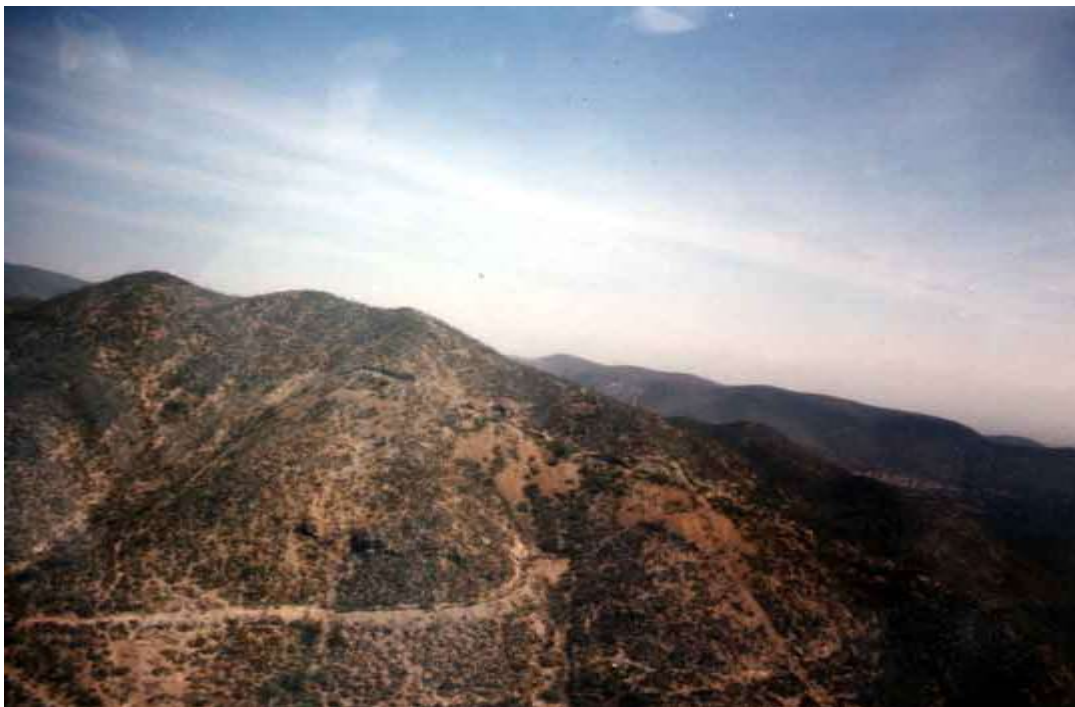
Tiros y derrumbes sobre el camino y falta de obras de contención o de restauración.
