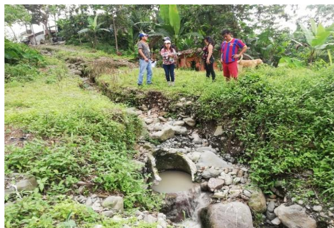
Foto 86. Descarga del Sistema de Alcantarillado Cantón Cumandá.
