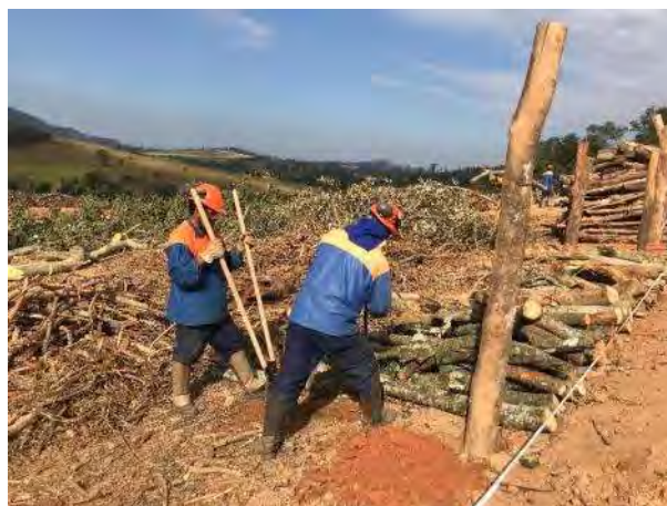
Foto 18 – Fixação de escoras de segurança nas pilhas de lenhas (Registro fotográfico 25/06/2021).
