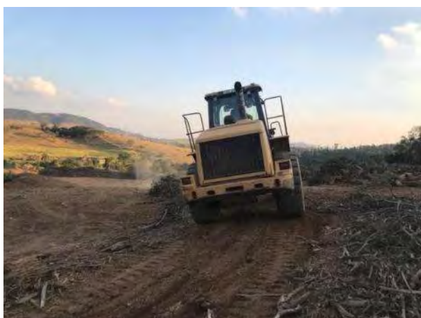
Foto 19 – Pá carregadeira concha realizando a atividade de limpeza do local de enleiramento 01 (Registro fotográfico 25/06/2021).
