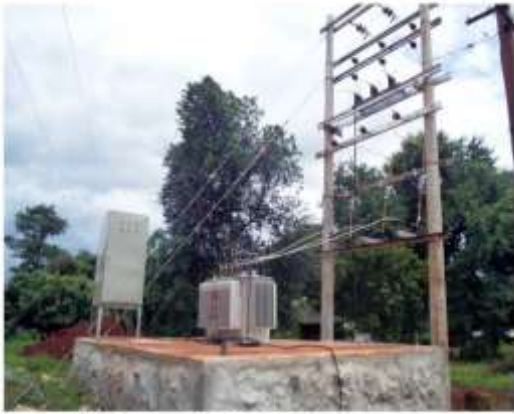
အင်းစိုင်းကျေးရွာတွင်တပ်ဆင်ထားသော Transformer
