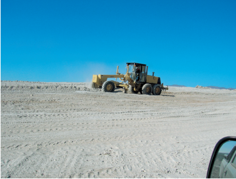
Foto 3. Vista de la motoniveladora preparando el terreno en la loma antes del subsolado y revegetación del lugar.
