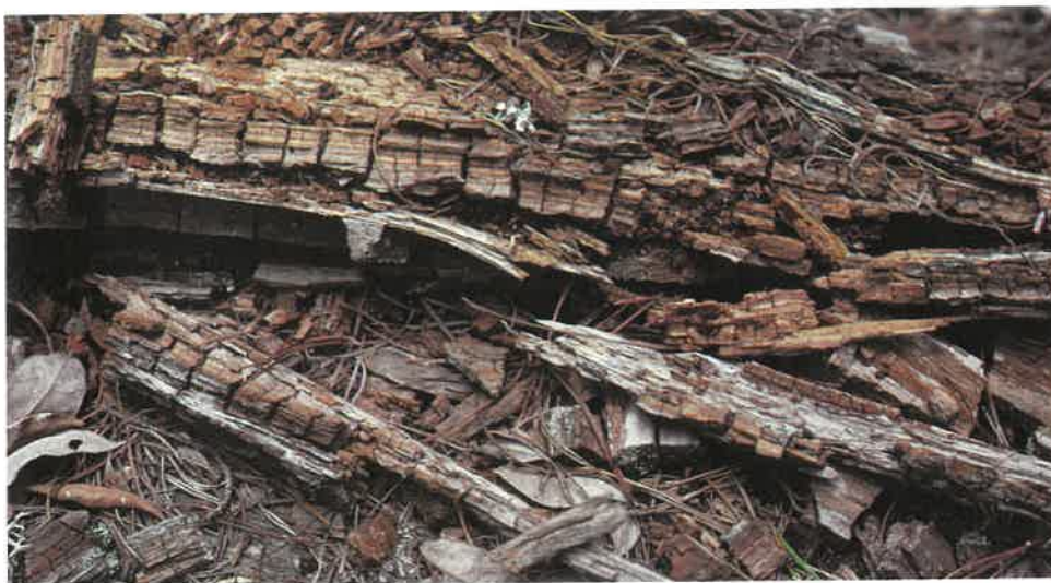
Brown cubical rot.
