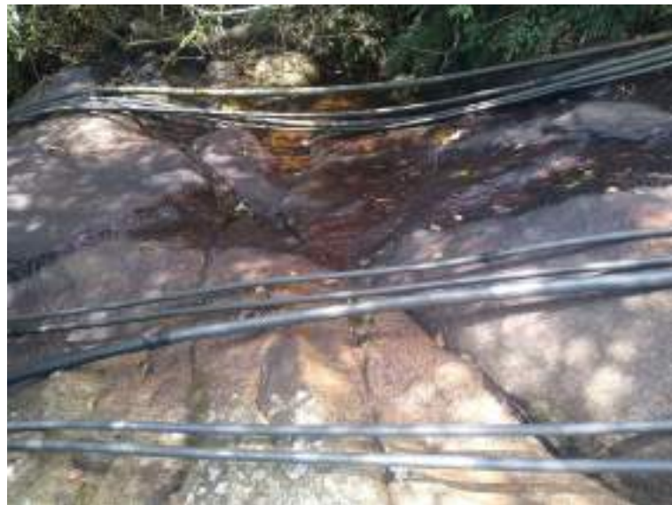
Figura 3 – Canos irregulares comprometendo a aparência do local e possivelmente diminuindo o nível da água no córrego.
