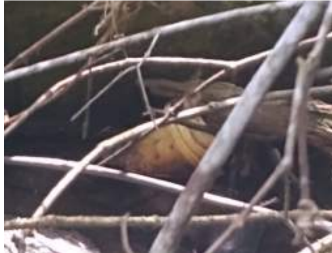
Figura 4 – Resto de manilha encontrada no interior do curso d'água.
