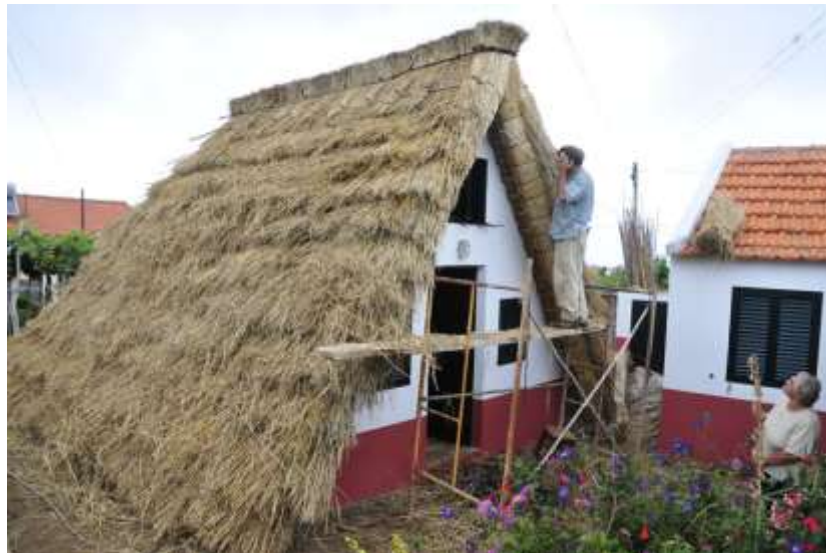
Figura 13. Colmatação de uma casa-de-fio típica de Santana
