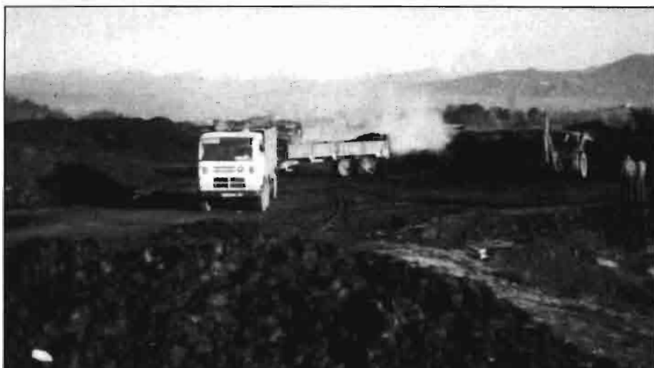
Vista general de las instalaciones de FERVOSA, en esta planta se remueven miles de metros cúbicos anualmente.
