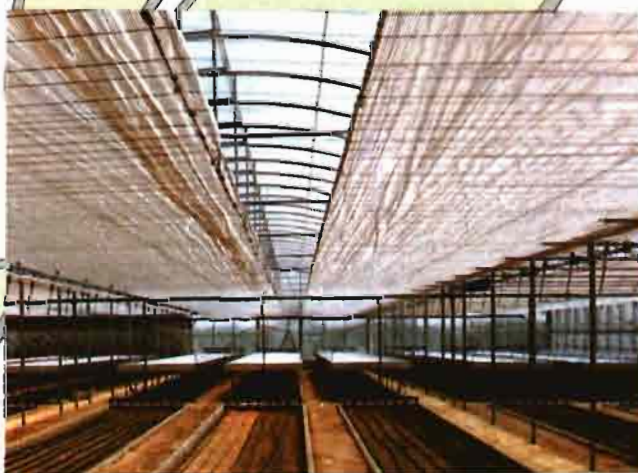
Instalaciones de 3.000 m 2 de invernaderos y equipamientos en la Escuela de Horticultura Ornamental de Reus.
