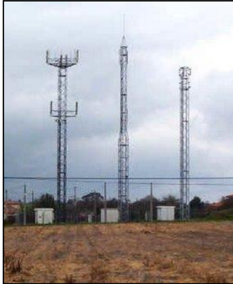
Foto 5.1 Antenas de telecomunicaciones
