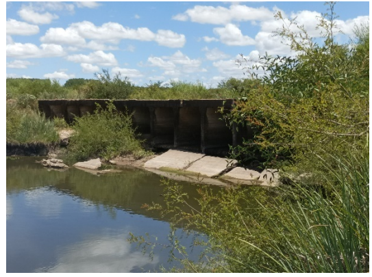
Se visualizan las losas inferiores partidas y semisumergidas en el Ao. Grande (cauce principal)
