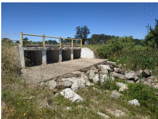
Alcantarilla tipo H en Ao. Barboza
