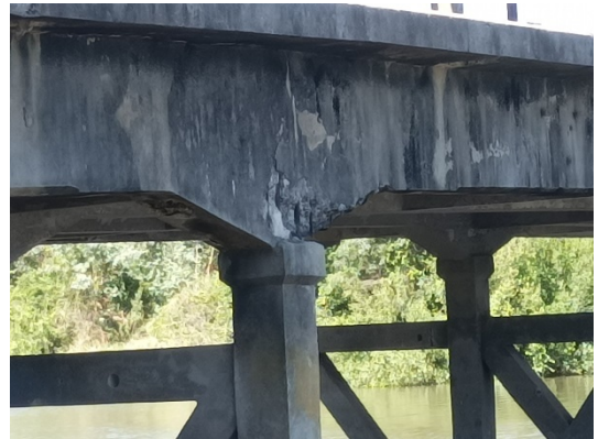
Vista del deterioro en pilares
