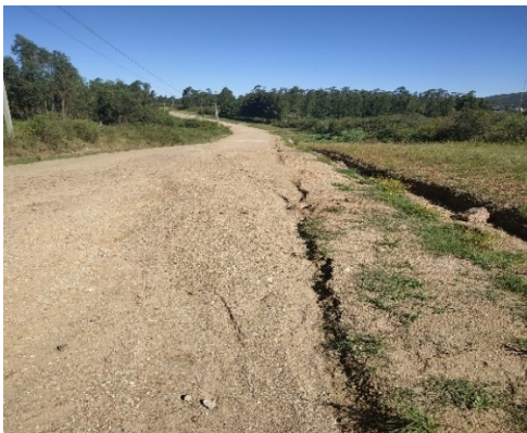
Vista de erosión en el camino
