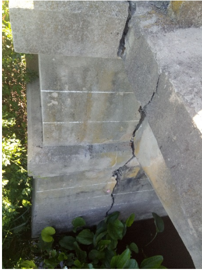
Fisura transversal en la cabecera este
