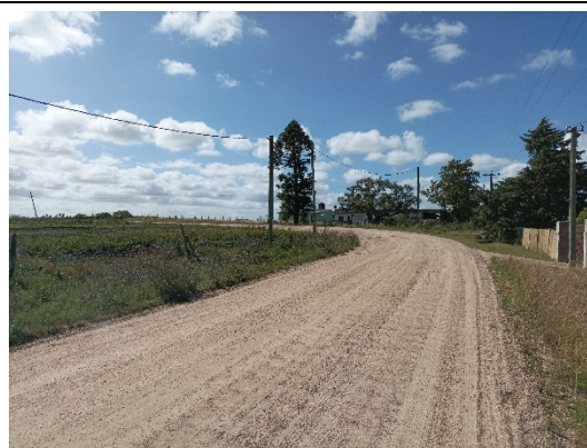
Curva cerrada con erosión incipiente por escurrimiento superficial
