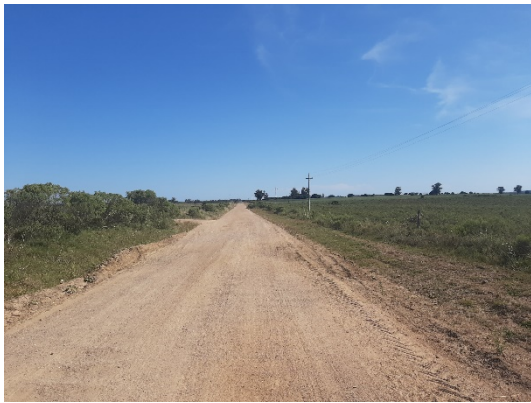
Visual característica del camino, se observan algunos hundimientos por sobrecarga
