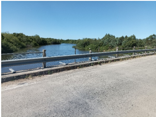
Vista de la baranda original interrumpida y protecciones metálicas
