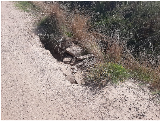
Derrumbe en alcantarilla circular
