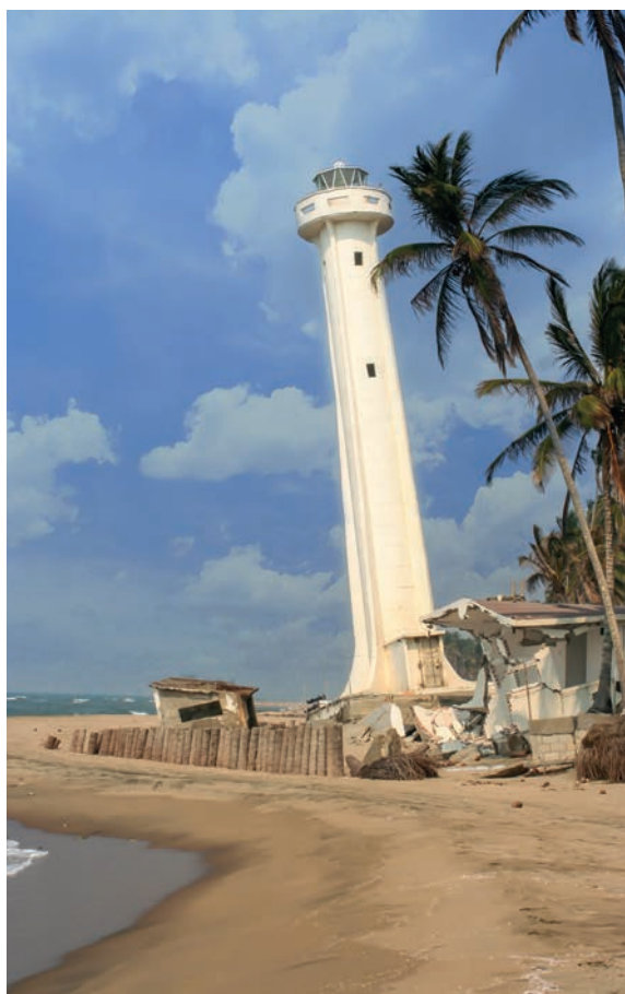
Figura 2. Retroceso de la línea de costa y faro inclinado en la Barra de Tupilco, en Comalcalco, Tabasco. Foto: Ricardo Collado-Torres.
