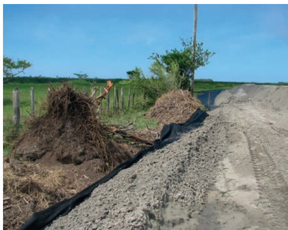
Figura 2. Interrupción de la escorrentía superficial por la residualidad resultante del terraplén de la carretera. Se considera significativo porque obstaculiza y modifica la continuidad de los procesos naturales, como son migración de especies acuáticas o muerte de zonas arboladas por exceso o disminución de la cantidad de agua. Foto: Víctor Roberto Carballo-Cruz.
