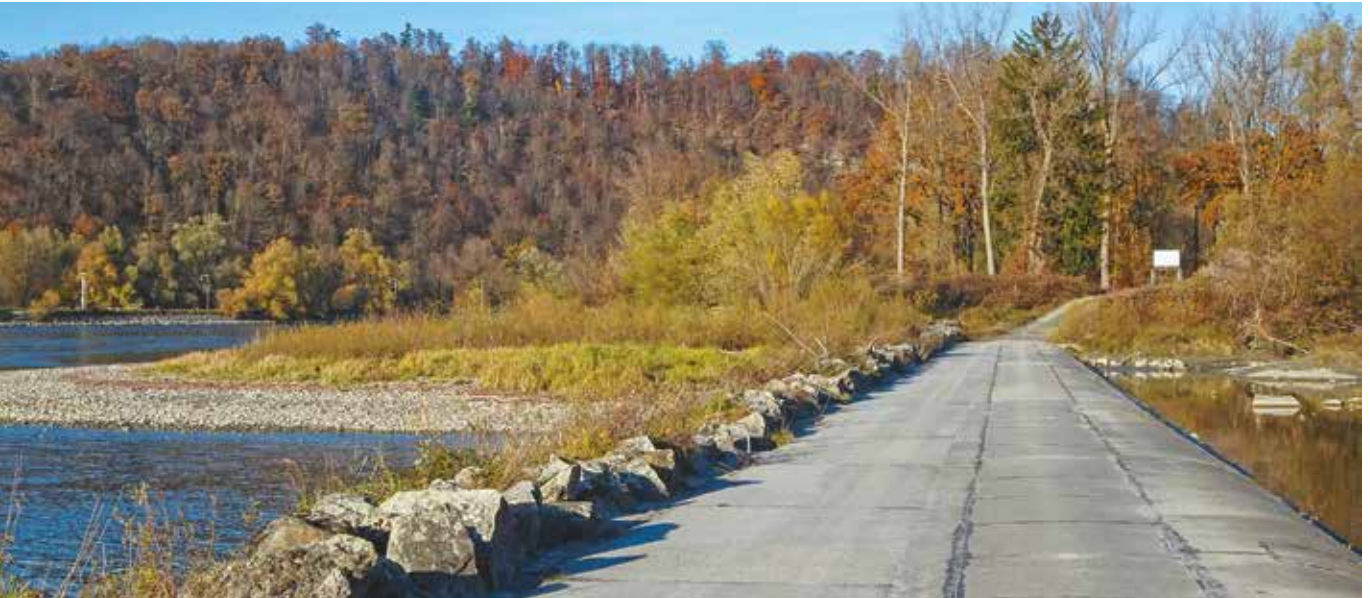
Abb. 28: Der Fahrdamm zur Soldatenau ist stromaufwärts mit aneinandergereihten Granitblöcken gesichert. Auf diesen haben sich Flechten angesiedelt, die Nährstoffeinträge und Kalkeinfluss belegen.
