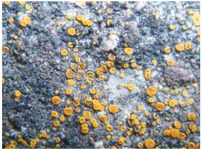
Abb. 34: Caloplaca crenulatella ist eine der kleinen Gesteinsflechten auf der Dammbewehrung, sie ist, obwohl Lückenbüßer, hinsichtlich des Substratchemismus' sehr aussagekräftig.
